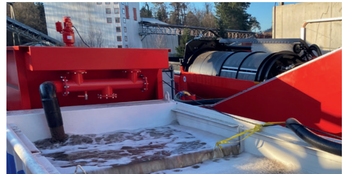
Lamellenabscheider im Einsatz
