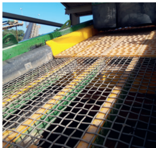
Wechselbarer Siebelag, im oberen Teil ein Meter PU, dann Draht.
