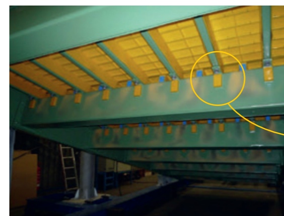
Zum Schutz vor Verschleiß werden die Nieten im Inneren der Siebmaschine mit PU Elementen abgedeckt.
